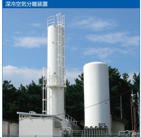
KPNシリーズ (高純度、大容量に対応、高圧ガス保安法の指定設備にも対応可能)
